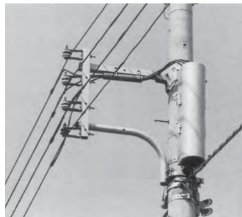
高低圧架空電線路
