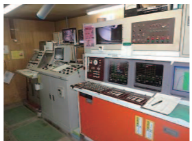
●計量室 コンクリートの材料を規定量で計量し、コンクリートミキサーで練り上げます。
