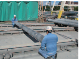
●構造試験 コンクリートポールの直径、長さ、足場ボルトのピッチ等測定し、合格判定をします。
