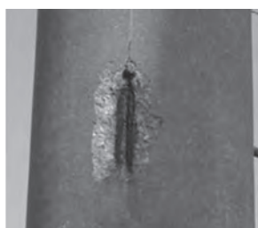
① 剥離したコン柱表面
