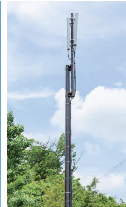
● アンテナ用ポール(大阪府箕面市)
