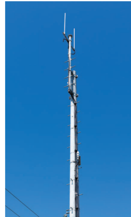
● アンテナ用ポール(兵庫県揖保郡)
