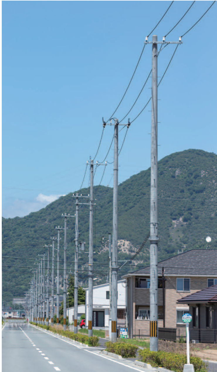
● 配電線用ポール(兵庫県赤穂市)
