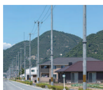
配電線用ポール 配電線用ポールは、家庭や工場に電気を送る重要なインフラです。当社では低コストで高耐久な製品特性を実現しています。
