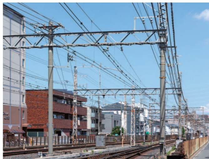
● 電車線用ポール(大阪府堺市)
