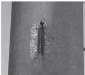
① 剥離したコン柱表面
